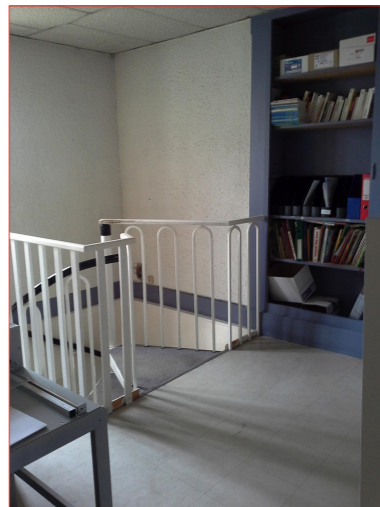
Escalier pas aux normes
